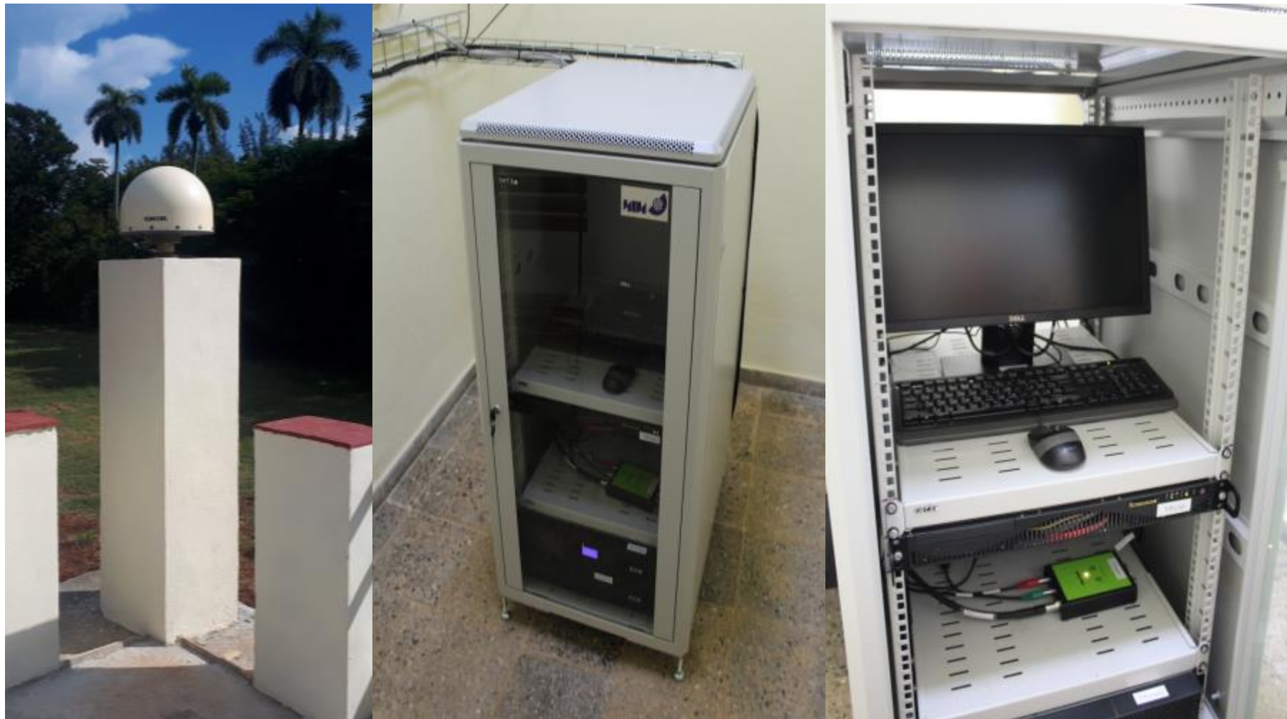
ГНСС- антенна (слева), напольный шкаф (по центру) с оборудованием «ГНСС-службы» (справа)
